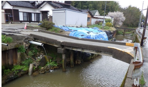
供用時（被災後）の状況
