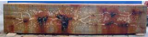
写真-2 外観状況 D13全No.2 (40A・day)
