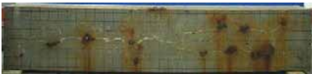
写真-1 外観状況 D13全No.2 (18A・day)
