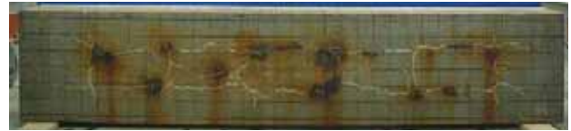
写真-4 外観状況 D16全No.2 (18A・day)
