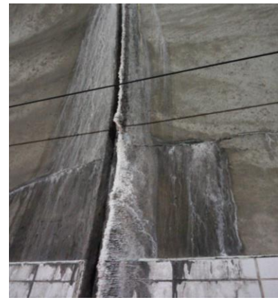
写真1 覆工の目地部の漏水事例
