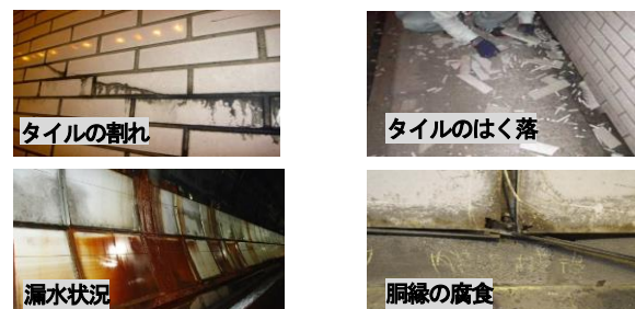
写真-1 内装工の変状例
